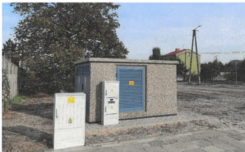
Nowy transformator przy ul. Targowej w Uniejowie fot. archiwum Urzędu Miasta w Uniejowie
