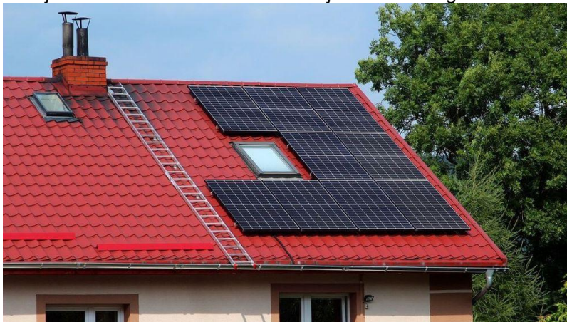
Fotografia 11. Instalacja fotowoltaiczna na dachu domu jednorodzinnego
