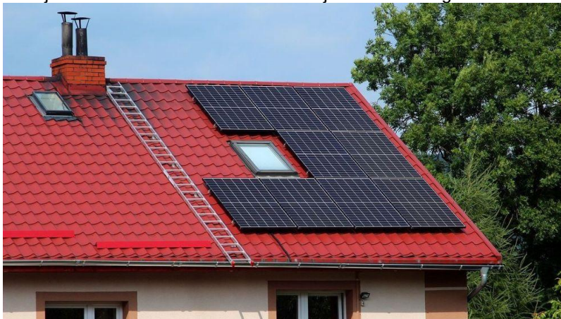
Fotografia 11. Instalacja fotowoltaiczna na dachu domu jednorodzinnego
